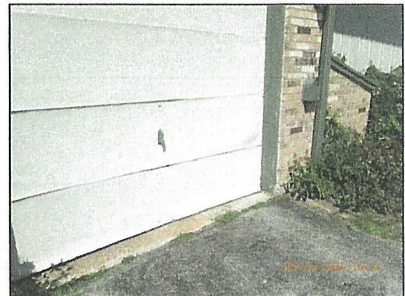
2039 - Garage door deterioration.
