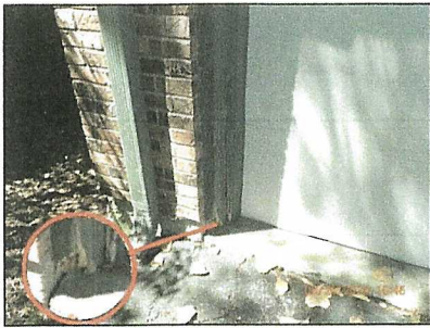
2025- Garage door jamb damage.
