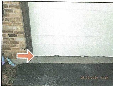
2046 - Garage door deterioration.
