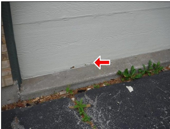
2034 - Garage door deterioration.
